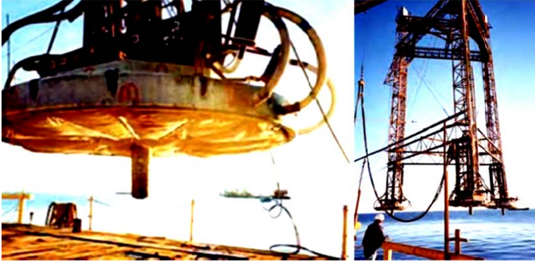
الشكل 12: اطار التثبيت الآلي وأكياس النسيج المقيدة المستخدمة في أساسات جسر الكونغفدرالية [13] ترميم الركائز والدعامات البحرية
